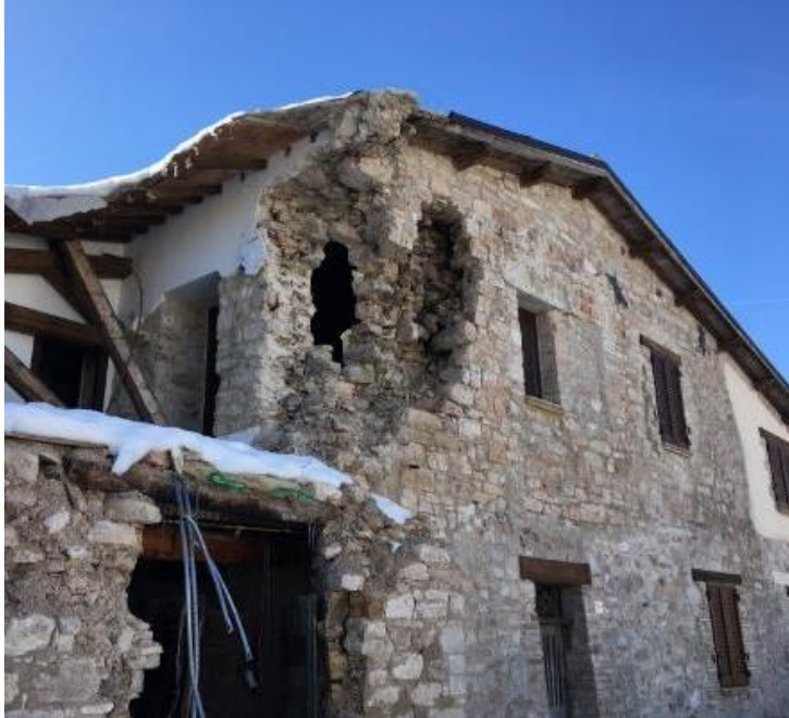
MODO 0 Disgregazione della muratura
