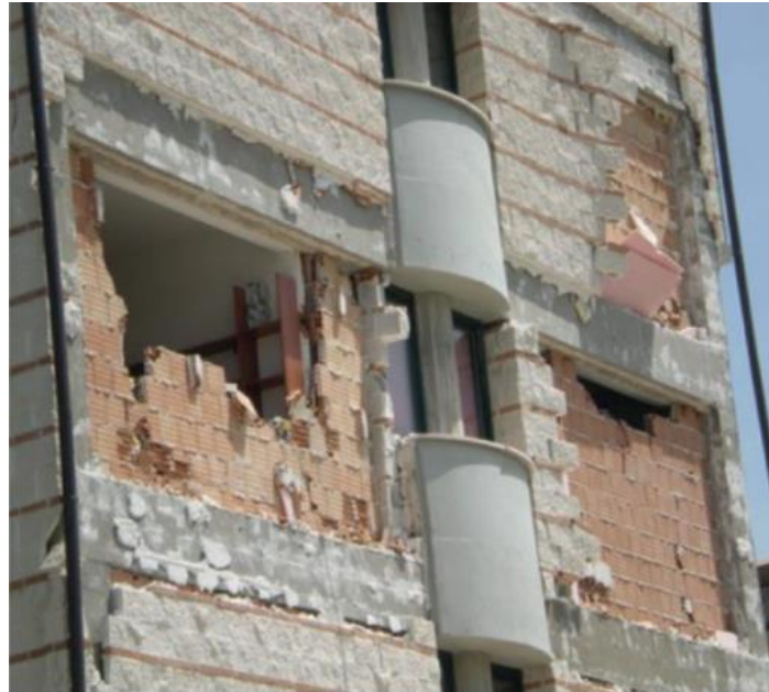
Ribaltamento delle tamponature
