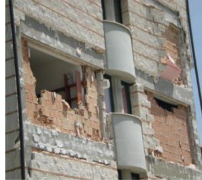
Ribaltamento delle tamponature
