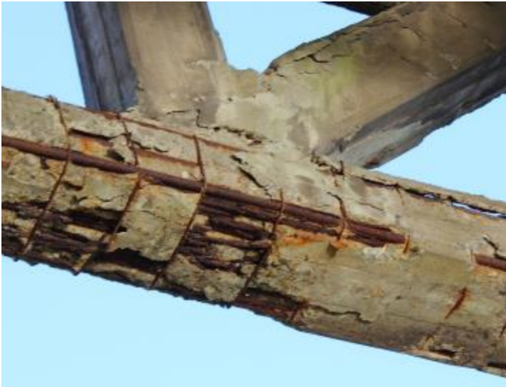
Degrado dei materiali
